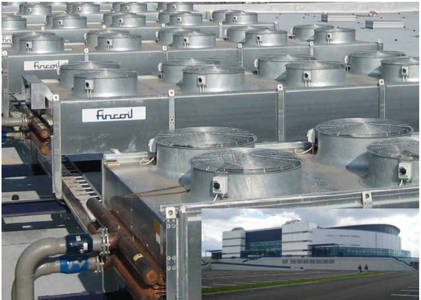
KATKO Sicherheitsschalter im Einsatz an Ventilationsanlagen in Kazan Sports Arena, Russia
